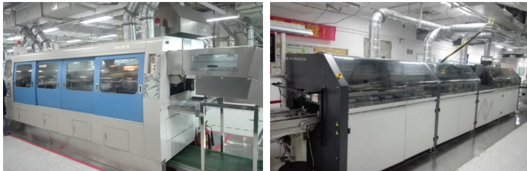
波峰焊替换 (左图:旧设备;右图:节能型新设备)
